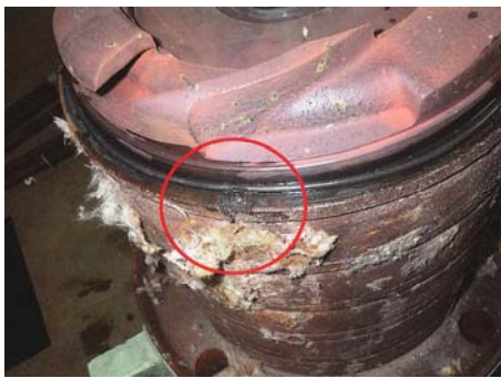
保温材噛み込み部
